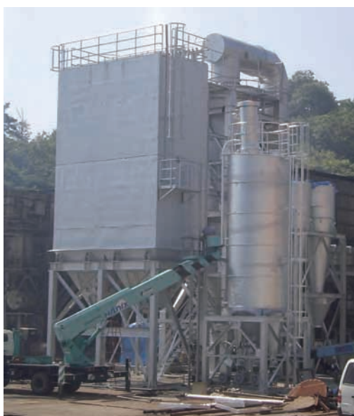
廃棄物焼却炉排ガス用集塵機
