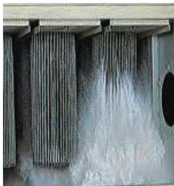
パルスにより粉塵を払い落とした様子
